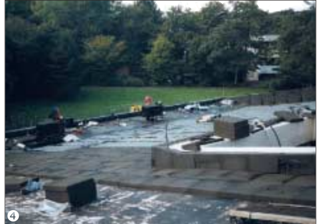
4 Abschnittsweises Verlegen von Dämmplatten und Dachabdichtung. Auch im Attikabereich wird die FOAMGLAS®-Wärmedämmung verlegt.
