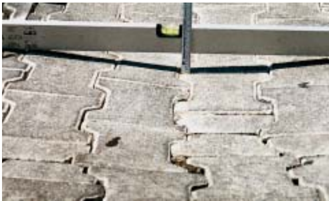
Dämmstoffschädigung und Pflasterauflösung bereits nach kurzer Zeit der Parkdachnutzung.
