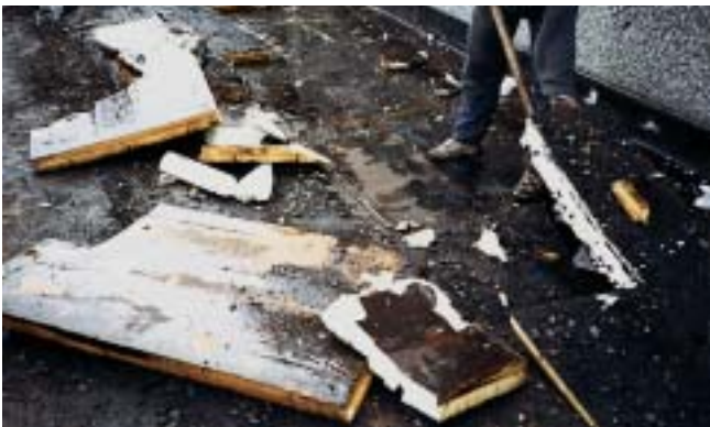
Nur mit hohem Aufwand kann die nasse Dämmung von der Dachfläche abgetragen werden.
