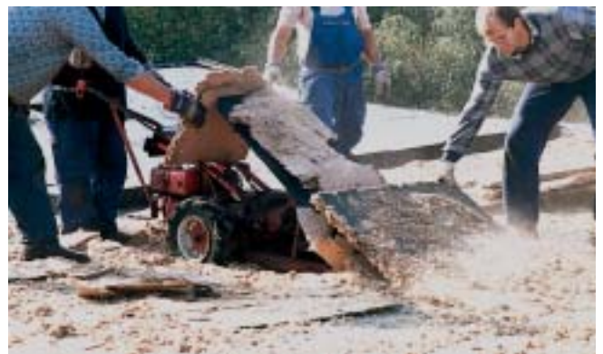
Entsorgung der schadhaften Dämmung verursacht hohe Kosten.
