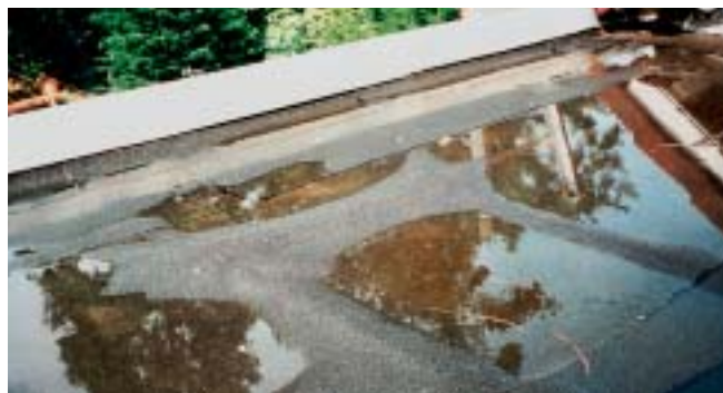
Systemschaden: PUR-Platten sind durch Schrumpfung derart eingefallen, dass Pfützenbildung entsteht.
