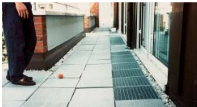
Verrutschte Gehwegplatten auf Terrassengängen; verursacht durch schadhaften PUR-Dämmstoff.
