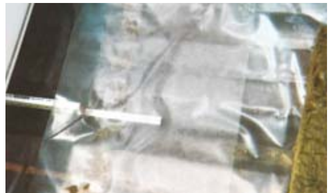
Luftströmung trägt Feuchte in das Dämmschichtpaket, weil Dampfsperren nicht vollständig verklebt sind.
