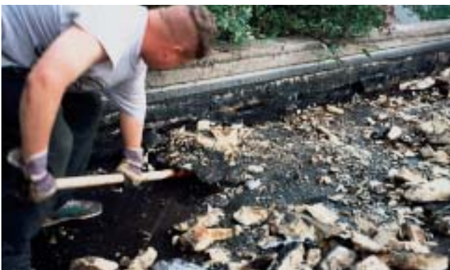
Zersetzung der PUR-Dämmung.
