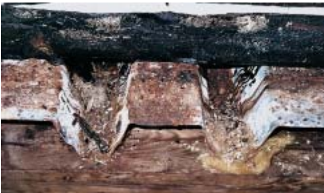
Schäden durch Korrosion an der Tragschale.
