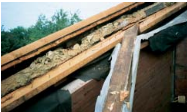
Dämmung nass und aufgequollen – Belüftungshohlraum geschlossen – Holzkonstruktion marode.
