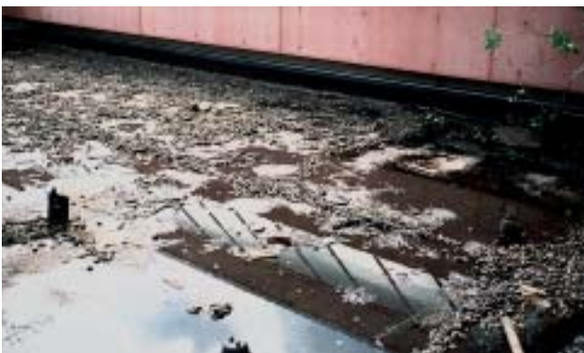
...und zur Ablagerung von Schlammkrusten.
