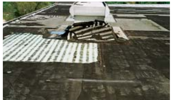
Die eingebaute Dampfbremse erwies sich als unwirksam.
