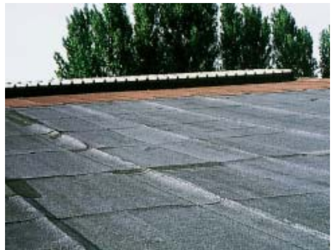
Schüsseln von Hartschaum-Dämmplatten; wie lange hält die Abdichtung?
