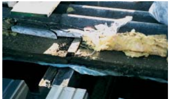
Durchfeuchtete und aufgequollene Mineralfaser.
