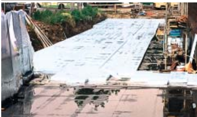
Typische Verlegesituation eines Umkehrdaches: 0°-Dach mit stehendem Wasser führt zwangsläufig zur Feuchteaufnahme.
