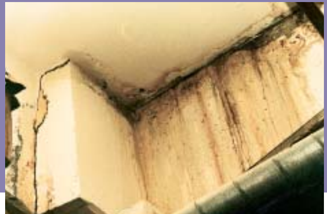
Schimmelpilzbildung bzw. Feuchteschäden
